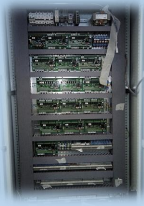
Щит управления освещением
