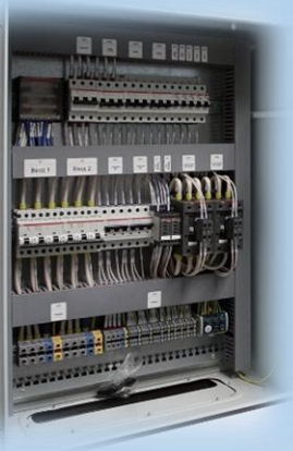
Автоматический ввод резерва
