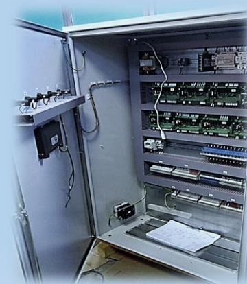
Щит управления вентиляцией
